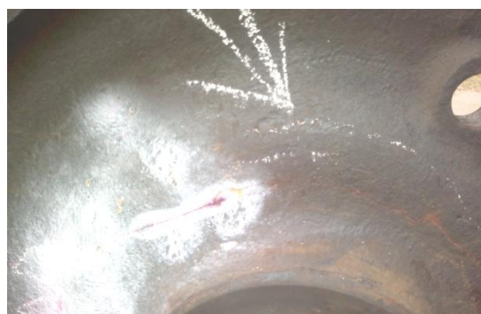
Поперечная трещина в диске колеса локомотива в районе ступицы
