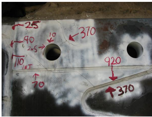
Вид индикаций от трещин на раме после проведения МТ контроля суспензией с чёрным порошком
